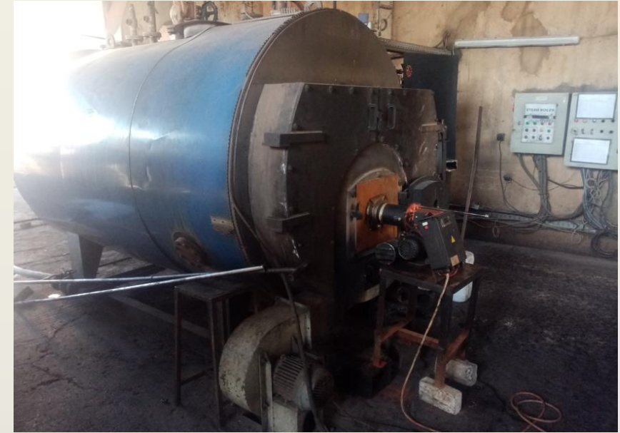
Chaudière usine d'anacarde
